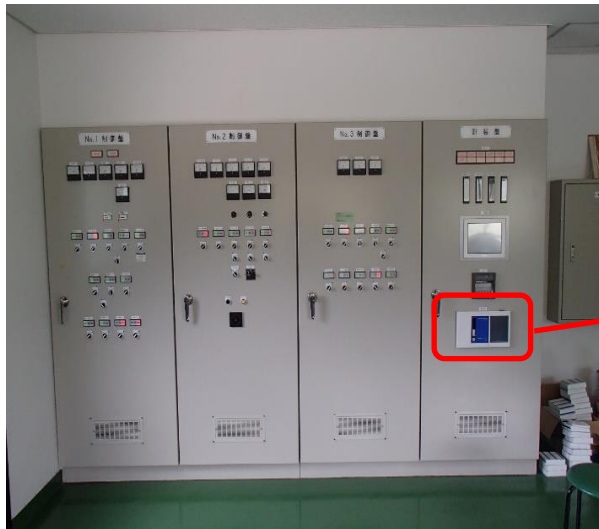
管理室動力制御盤
