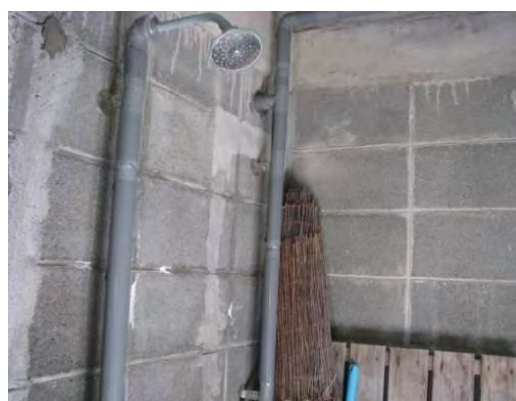
老朽化部分写真
