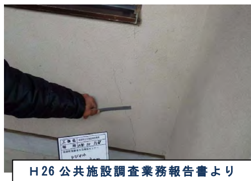
施設老朽化写真
