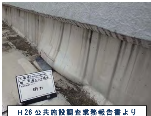
老朽化部分写真
