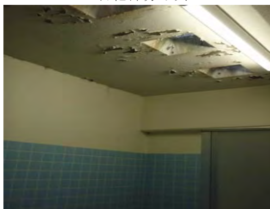
老朽化部分写真
