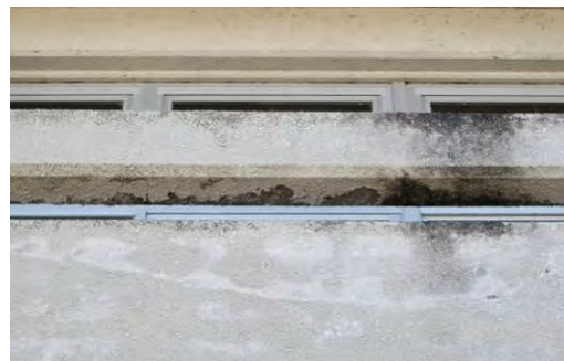
老朽化部分写真
