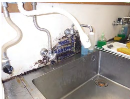
老朽化部分写真
