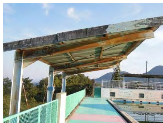
老朽化部分写真
