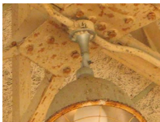
老朽化部分写真
