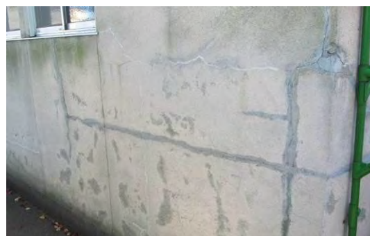
老朽化部分写真
