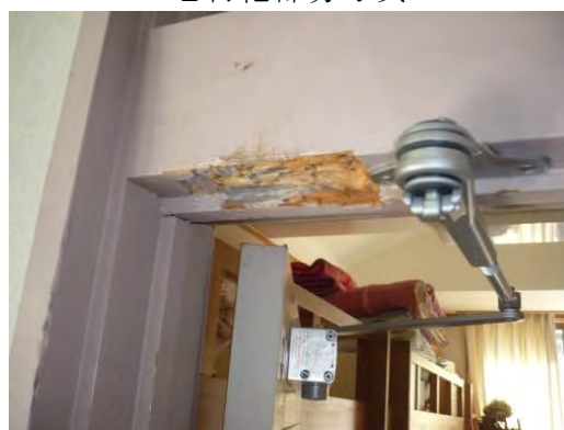
老朽化部分写真
