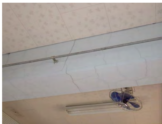
老朽化部分写真
