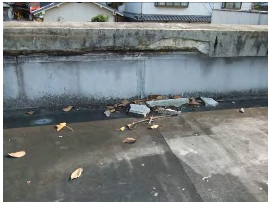
老朽化部分写真
