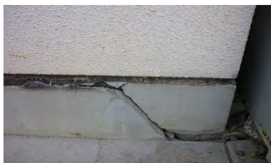
老朽化部分写真
