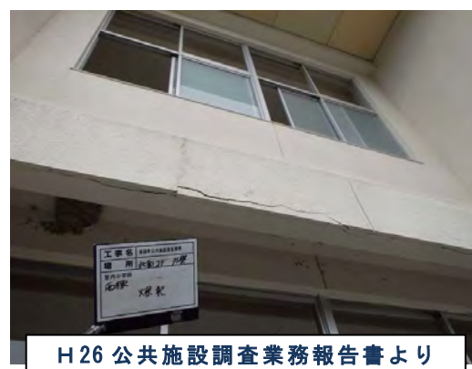
老朽化部分写真
