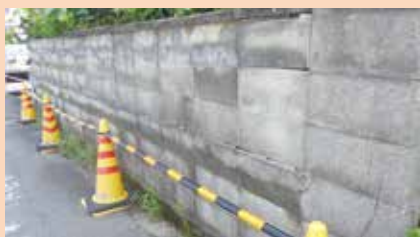
ブロック塀倒壊の恐れ(通学路)
