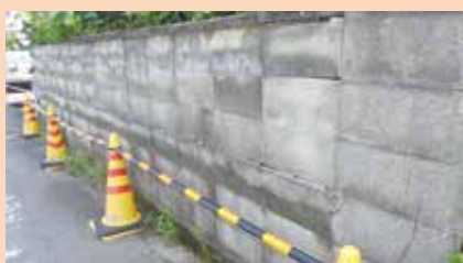
ブロック塀倒壊の恐れ(通学路)
