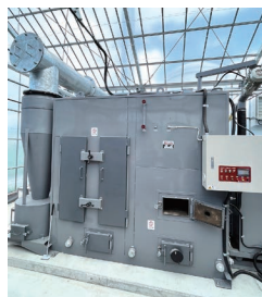
温室ボイラー
