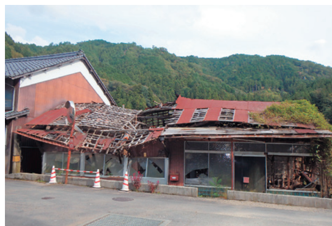
危険な空き家
