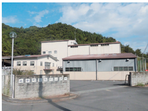
老朽化が進行中
