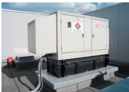
中学校にある非常用電源装置
