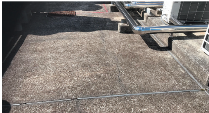
見えにくいけどヒビがいっぱい！（築30年以上経過した庁舎屋上）
