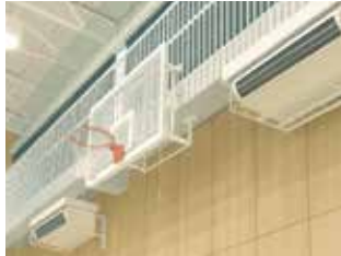
体育館空調設備(イメージ)
