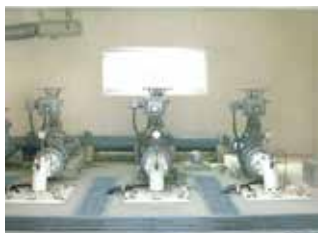
第4水源ポンプ室
