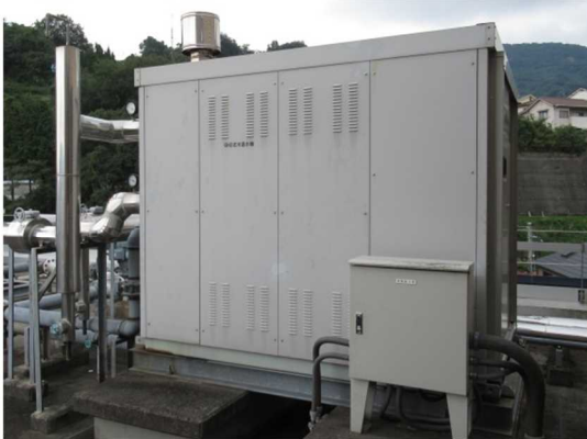
灯油焚き吸収冷温水機80RT(AH-1)
