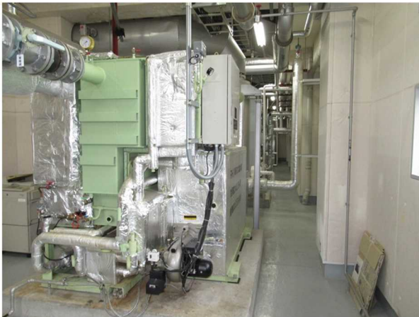
A重油焚き吸収冷温水機120RT(RH-1)
