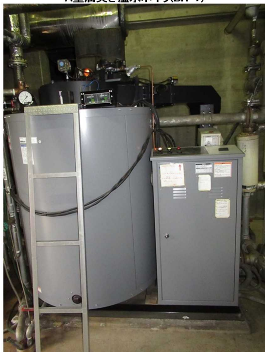
A重油焚き温水ボイラ(BH-1)
