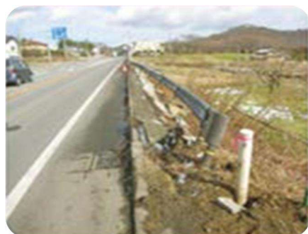
ガードレール・ 標識等の損傷
