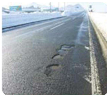
路面の穴ぼこ・ 段差
