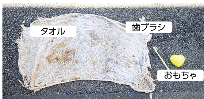
ポンプ緊急停止の原因となった異物
